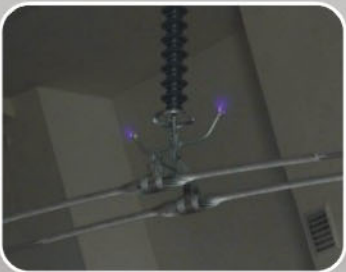
均压环电压试验 Corona voltage test
